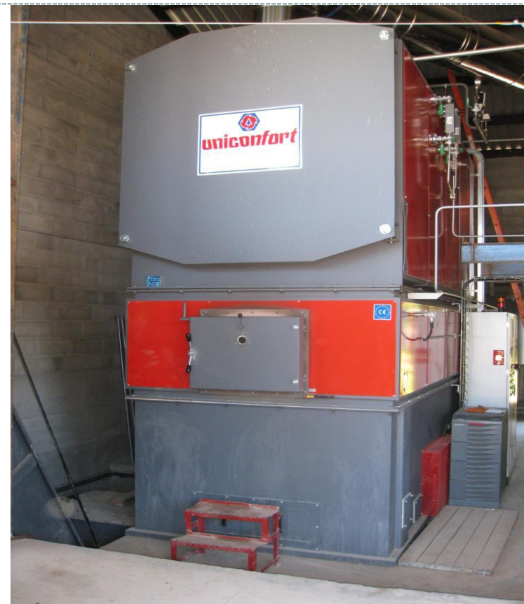
Chaudières à biomasse avec valorisation des sous produits issus de la distillation
